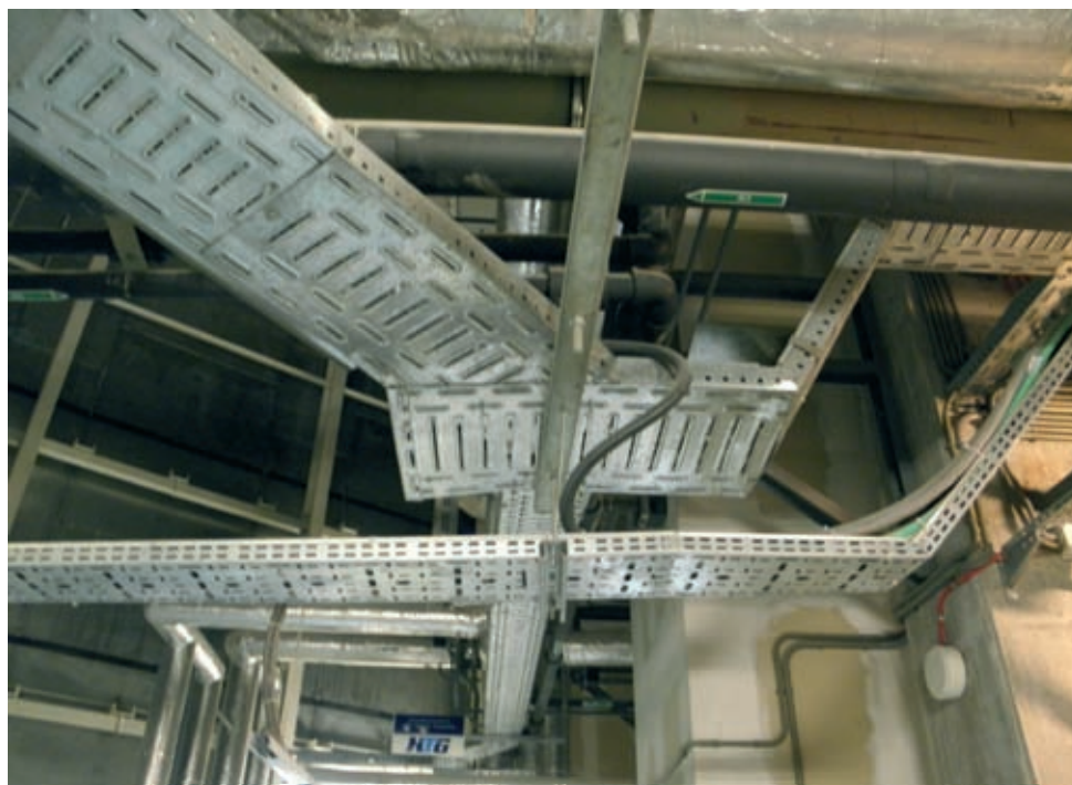
Rys. 1. Trasy kablowe w pomieszczeniu technicznym budynku wielokondygnacyjnego
