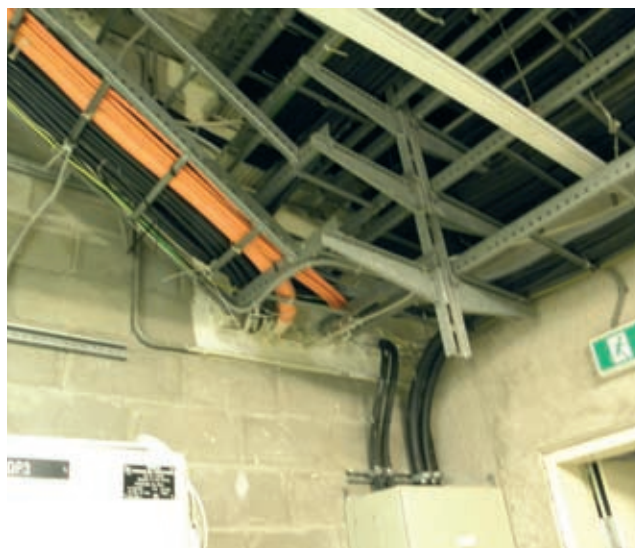
Rys. 2. Drabinki kablowe, elementy nośne, wiązki kablowe – również z kablami ognioodpornymi
